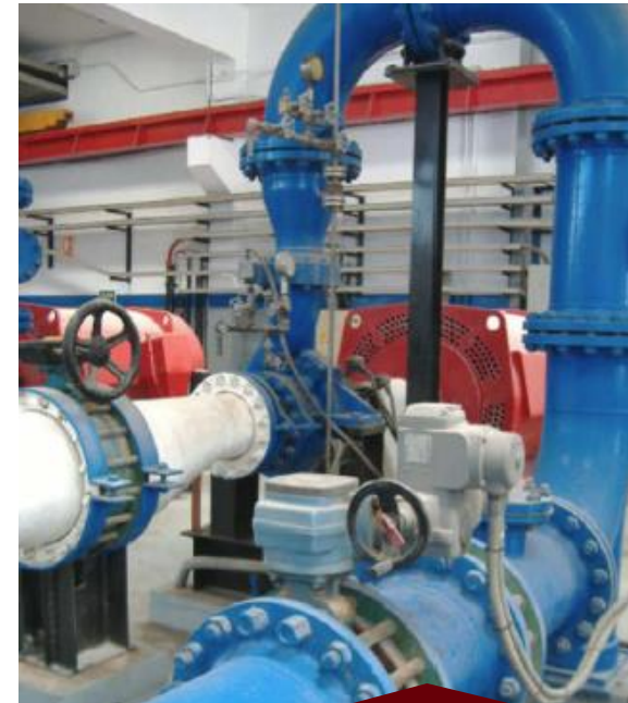
Estaciones de bombeo: Método termodinámico para la medición de la eficiencia energética. ISO 5198
