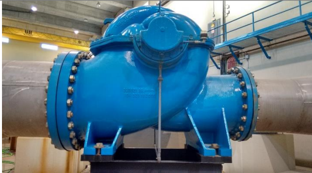
Estación de bombeo "Rio Tinto" (5 x 700 kW)
